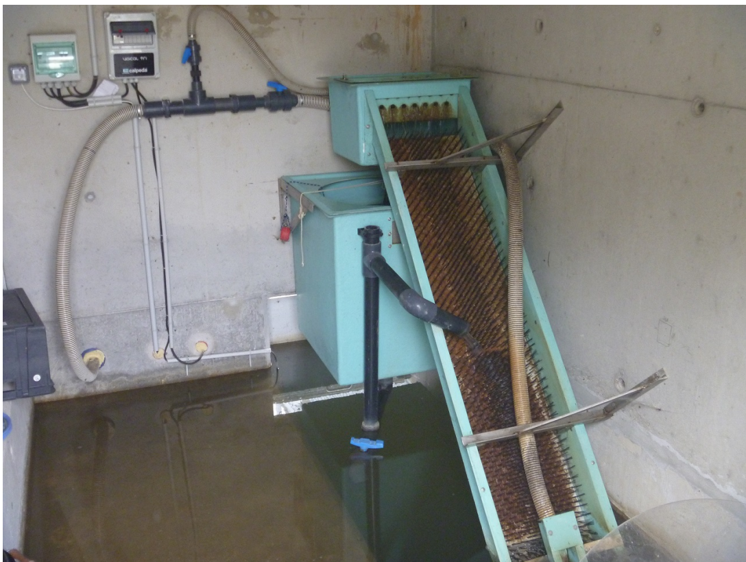
FIGURE 11 – Passe piège à anguilles en rive droite du barrage de Poses - Amfreville-sous-les-Monts
