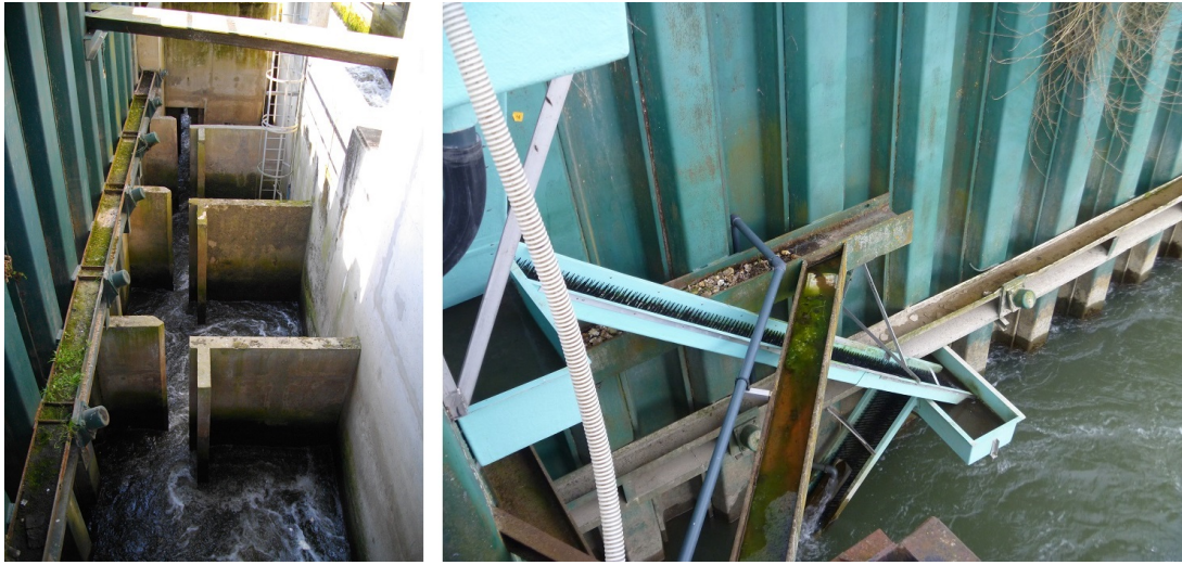
FIGURE 5 – Dispositif de franchissement en rive gauche du barrage de Poses - Amfreville-sous-les-Monts. A gauche, passe à bassins à fentes verticales ; à droite, rampes de types « tapis-brosse »
