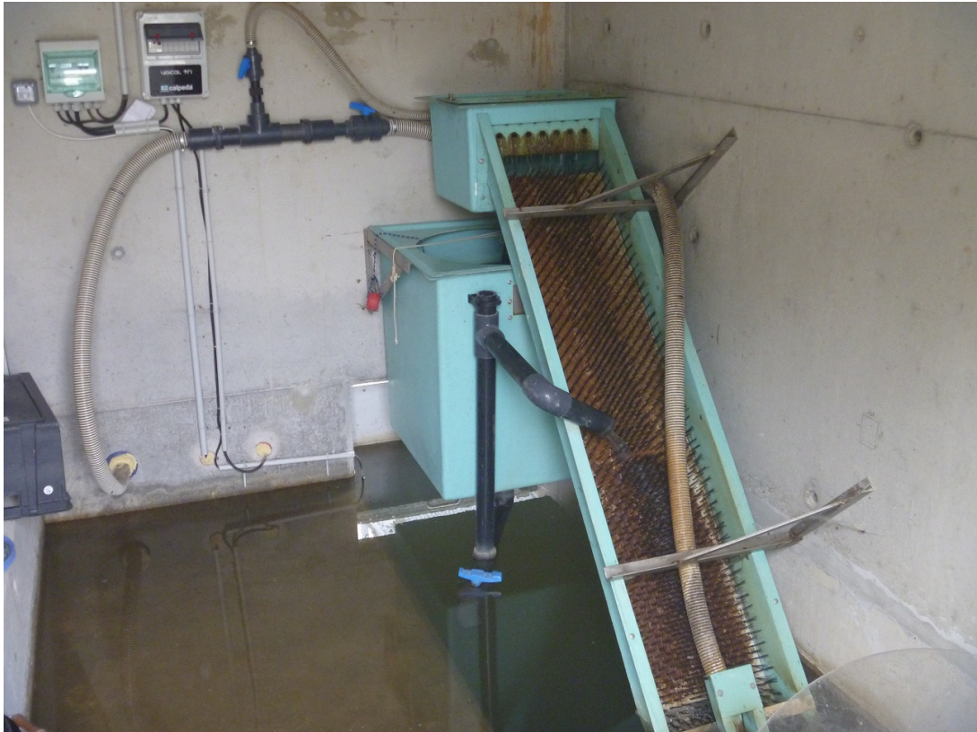
FIGURE 11 – Passe piège à anguilles en rive droite du barrage de Poses - Amfreville-sous-les-Monts
